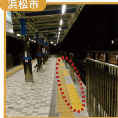
2018年2月施工: 点字ブロック凸凹シート 遠州鉄道(株) 様 (東急建設(株) 様)
